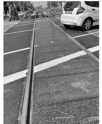
DB Strang: repariert
