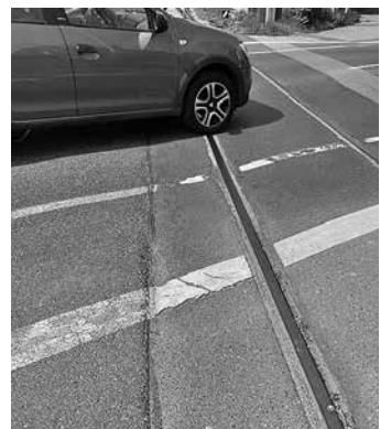
Engländer Strang: nicht repariert
